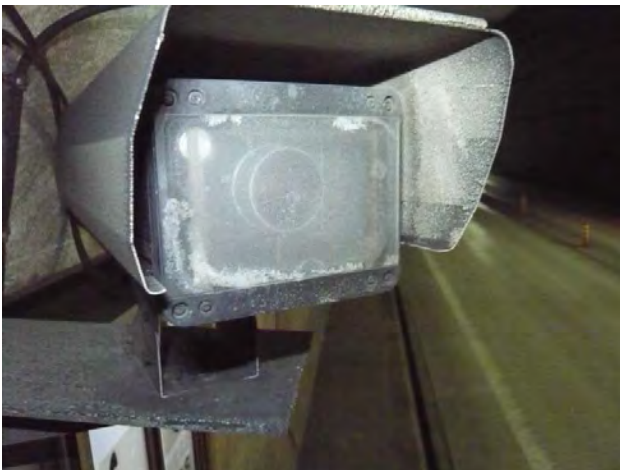
写真-2 非常駐車帯監視用CCTVカメラ（本体）
