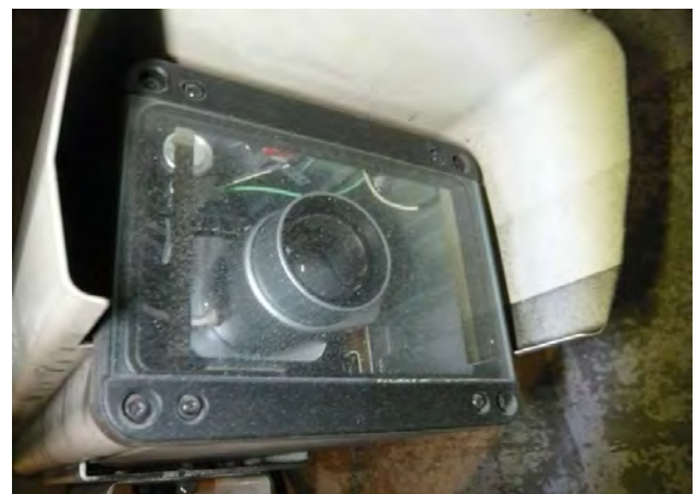
写真-5 通常のトンネル内CCTVカメラ（本体）
