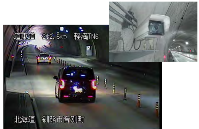
写真-1 道路トンネル内CCTVカメラ
