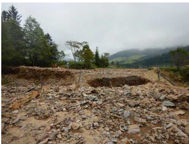
写真-7 串内地区の幹線道路被災状況
