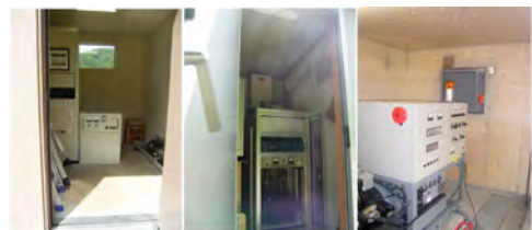
写真-1 施設格納重要機器
