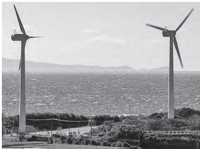
駒井ハルテック社製の中型風力発電機（300kw）
