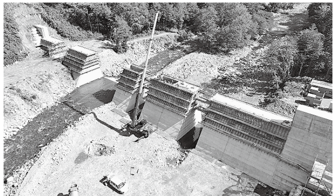
戸鶯別川第4号砂防堰堤
