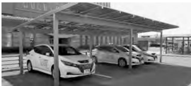
写真) 令和4年度道有施設の新エネ導入・省エネ加速化事業による渡島総合振興局の取組。公用車EVの3台導入とともに太陽光発電付きカーポートを設置。充電設備も併設し、災害時に非常用電源として利用可能となるV2Bシステムを構築。
