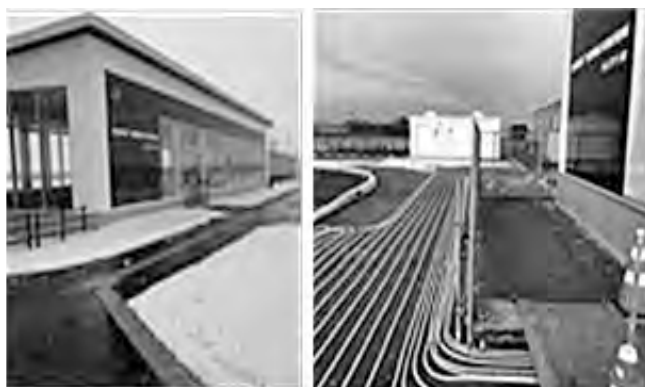
写真) 令和4年度新エネルギー設備導入支援事業による当別町の取組。JR学園都市線「ロイズタウン駅」の駅前広場で、地中熱を活用した融雪設備（ロードヒーティング）を導入。
