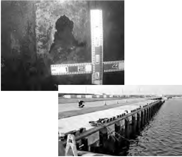
矢板が腐食した係留施設の老朽化対策例
