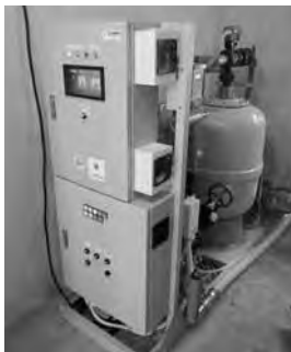
トクアン漁港に設置された、海水電解浄化装置
