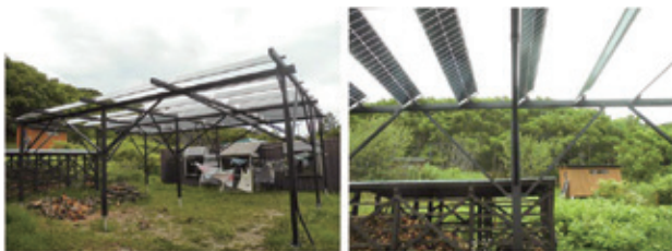
図3 ソーラーシェアリング設置状況(左)およびパネル裏面(右)
