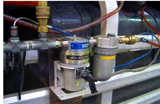
写真-2 燃料タンク脇に設置した燃料流量検出器
