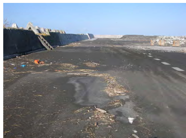
写真-1 2014年11月5日 被害状況
