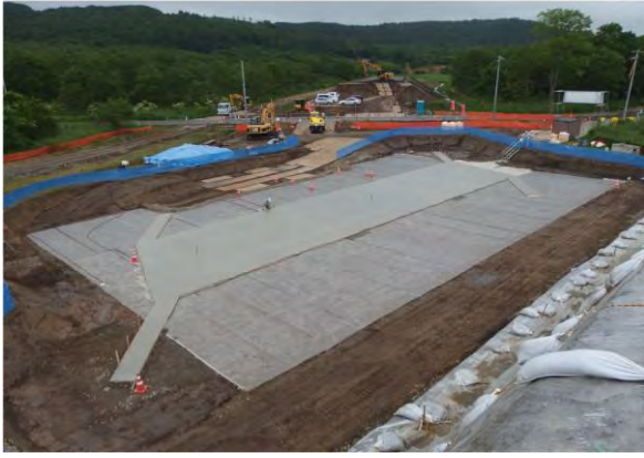
写真-3 カルバート基礎補強工の施工状況 (No.4 ボックスカルバート)
