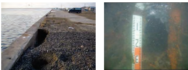
【写真1】 係留施設の老朽化状況
