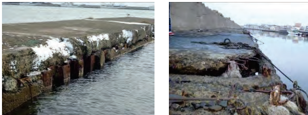
【写真2】 外郭施設の老朽化状況
