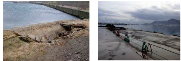
【写真3】エプロン陥没と施設利用制限状況
