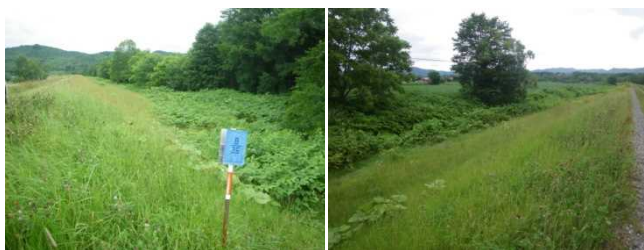
図 2-2 オオイタドリ対策工による生育抑制事例 (H25 施工 湧別川 野上左岸築堤)
