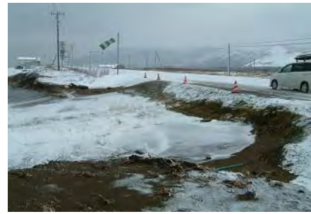
(a) 被災事例1 (A地区)
