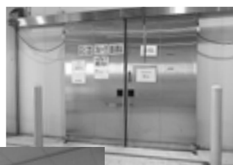
冷蔵、冷凍用の保管庫もある
