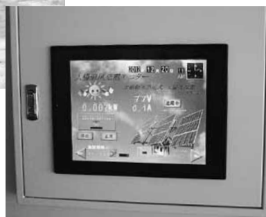
町民センター入り口そばの壁に埋め込まれたモニター
