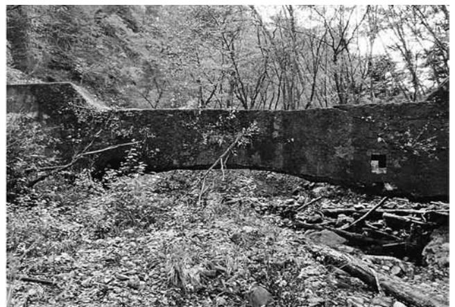
写真7 老朽化して底抜けした治山ダム
