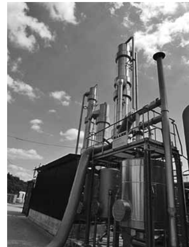
図6 バイオガス精製ユニット
