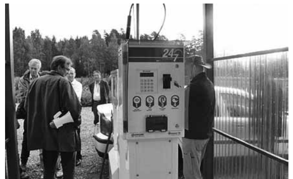
図11 バイオメタン供給ステーション
