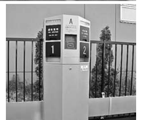
6月に完成した給電スタンド
