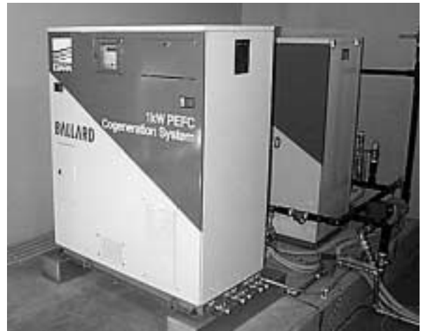
2001年度から実験住宅に導入している固体高分子形燃料電池の外観
