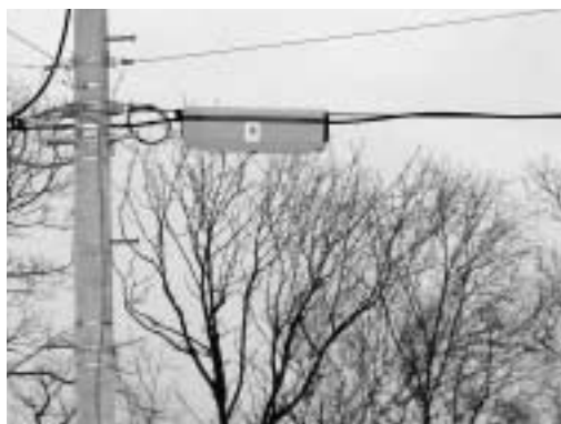
電柱に架設された光ファイバー
